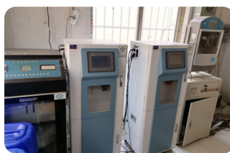
廢水線上監測系統
